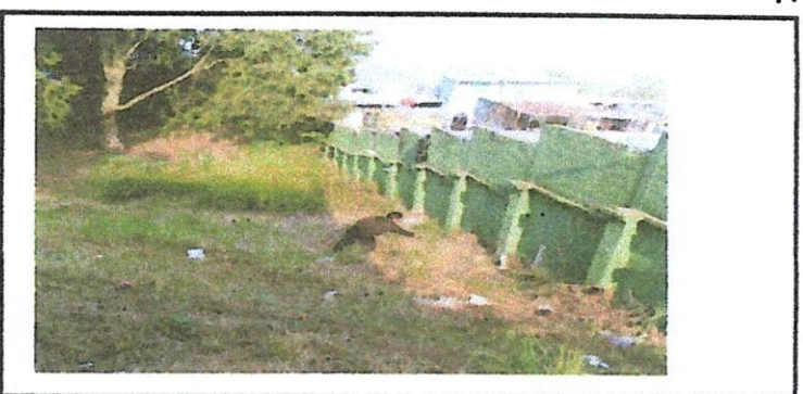
Foto: 6 Muro muy bajo necesita aumentar altura.
