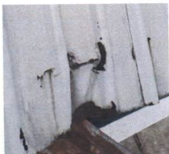
Foto 3: Daños por los vientos
