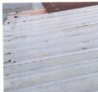
Foto 4: Deterioro en láminas
