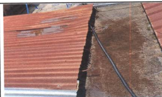
Foto 6: Láminas que sedieron por las lluvias
