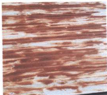
Foto 5: Daños en laminas
