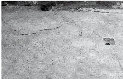
Foto 2: Tercera losa y tapadera de concreto dañada.
