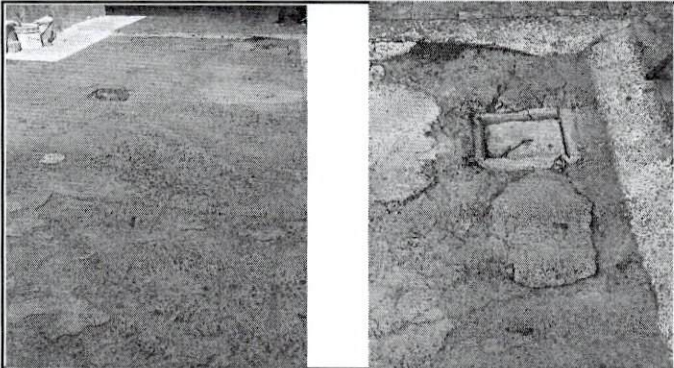
Foto 1: Dos losas y dos tapaderas de concreto dañadas.
