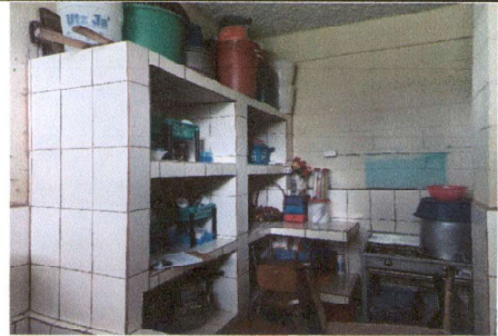
FOTO 10: SUSTITUCIÓN DE PISO Y AZULEJO EN COCINA. (SE INSTALARON ÚNICAMENTE 30M2 DE AZULEJO Y LA COCINA YA NO CUENTA CON MÁS ESPACIO PARA INSTALACIÓN DE AZULEJO, LOS 63 M2 RESTANTES SE DEBERÁN INSTALAR EN OTRA ÁREA Y DEJAR CONSTANCIA EN ACTA)
