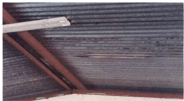
Foto 4: Vista de láminas deterioradas dentro del aula
