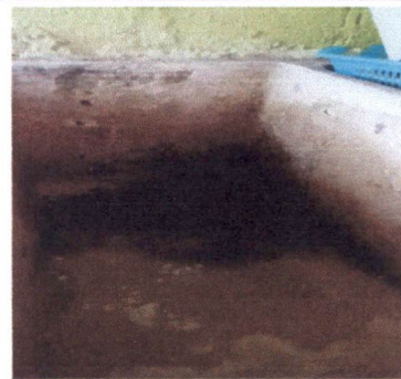
Foto 12: Fondo de la pila deteriorado
