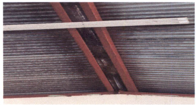
Foto 2: Vista de capote por dentro del aula deteriorado
