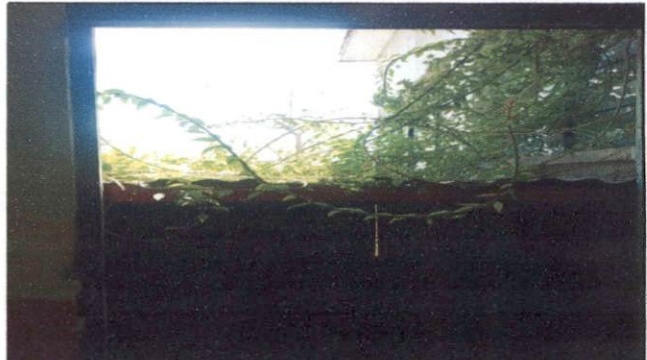
Foto 2: Sustitución de lámina, por lámina troquelada aluzinc calibre 26 y levantamiento de 2 metros para evitar caída de agua ( para 1 salon)
