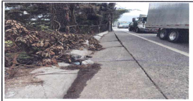
Foto 6: VISTA GENERAL MUESTRA EL DAÑO DE CANTIDAD DE METROS.
