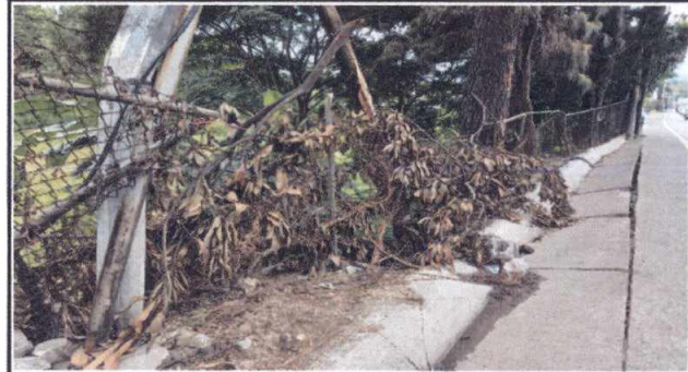
Foto 2: DAÑADO CANTIDAD DE METROS DEL MURO PERIMETRAL BASE, PARED Y CIMIENTOS PARA LA MALLA DE METAL
