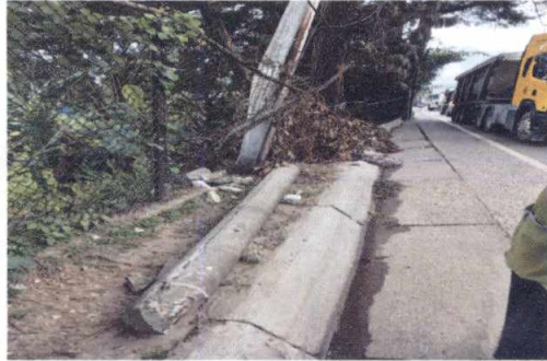
Foto 1: MURO DAÑADO POR ACCIDENTE VEHICULAR
