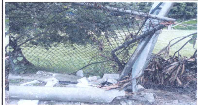
Foto 4: DESTRUCCION DE ACERA, MALLA, POSTES DE TELEFONO Y ENERGIA ELECTRICA.
