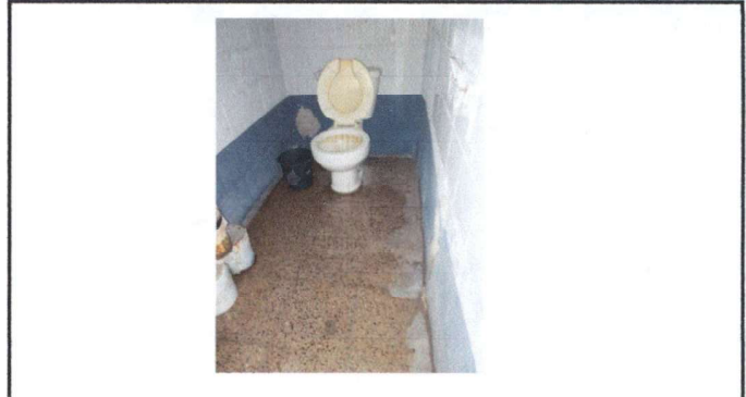
Foto 14: Reemplazo de sanitario en área de maestros, se cobra únicamente el costo de artefacto y materiales.
