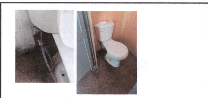
Foto 12: Reparación de fugas de sanitarios, incluye desmontaje, reparación y reinstalación, y sustitución de manguera y llave de paso
