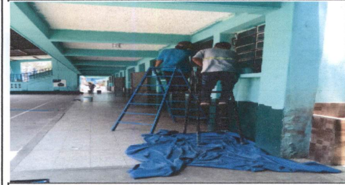
Foto 3: Pintura en áreas del primer nivel cocinas, bodegas, aulas, sanitarios y módulo 2 de gradas.
