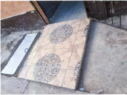
Foto 3: Ausencia de Banqueta en Ingreso
