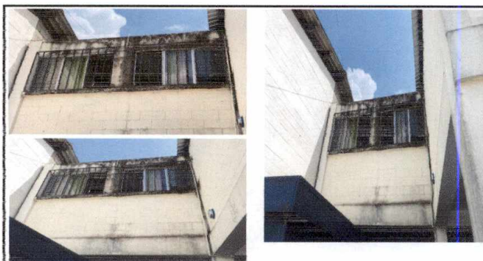
Foto 16: Filtraciones de Dirección
