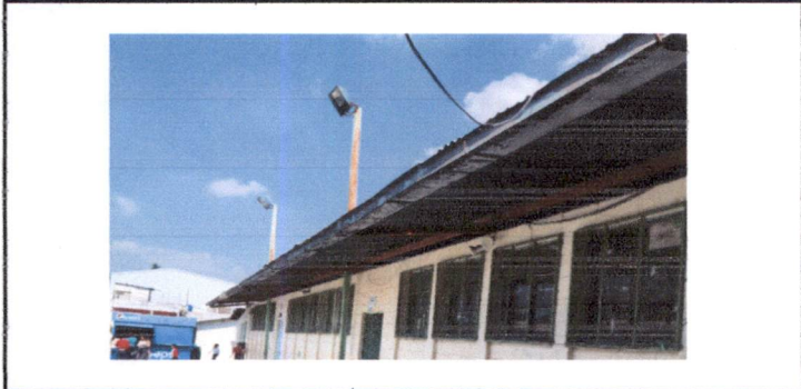
Foto 3: Módulo 1 de aulas. Pintura de estructura de techo presenta corrosión
