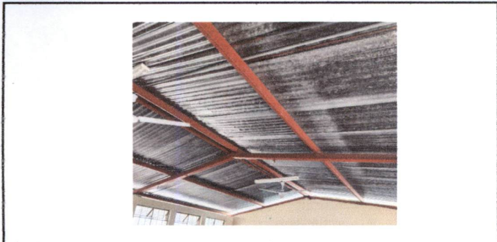
Foto 1: Módulo 1 de aulas. Lámina de techo de aulas deteriorada y en mal estado, presenta filtraciones
