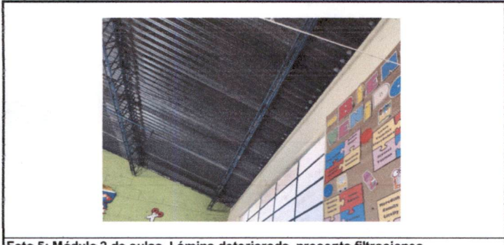
Foto 5: Módulo 2 de aulas. Lámina deteriorada, presenta filtraciones
