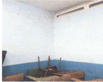
Foto 2: Filtración de agua en muros interiores
