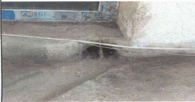
Foto 7: Reparacion bajada pasillo Sanitarios por filtracion
