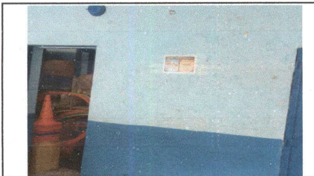
Foto 11: Filtracion en pasillo sanitarios
