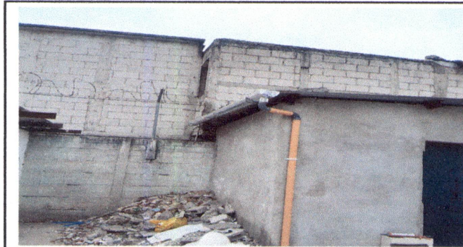
FOTO 13 : CANALES PLUVIALES Y BAJADAS DE AGUA DE BODEGA
