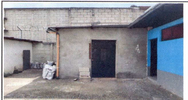
FOTO 14 :CANALES PLUVIALES Y BAJADAS DE AGUA DE BODEGA
