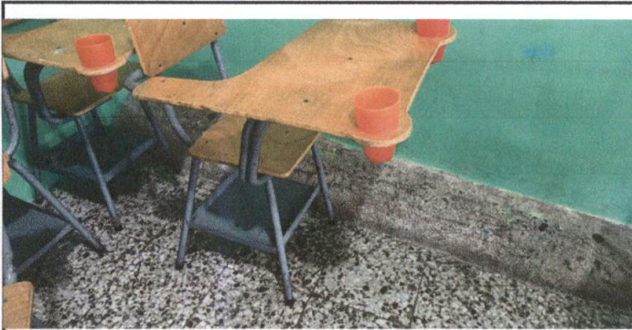
Foto 3: En el aula de 1ro. B pasa un tubo de drenaje que no se puede remover, lo que provoca una grada de 8cm de alto en el aula, lo que le quita espacio a los alumnos.
