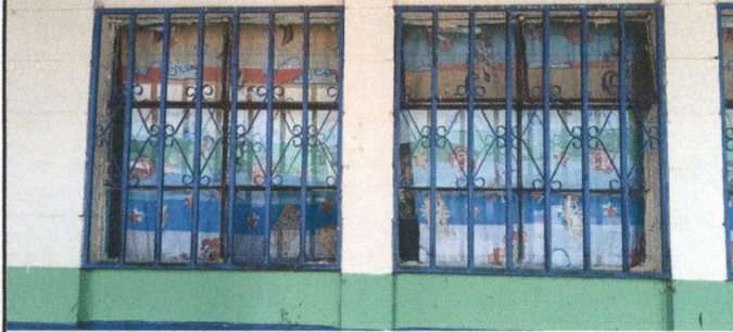
Foto 1: Las ventanas no se pueden abrir, y las que se pueden, abren poco, por lo que las clases no tiene ventilación.
