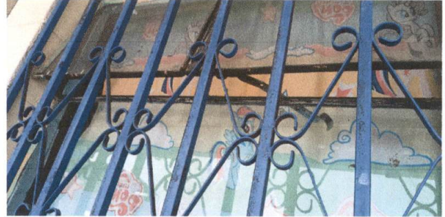
Foto 2: La estructura de las ventanas esta dañada y si se abre corre el riesgo de desprenderse la pieza completamente.
