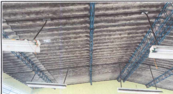
Foto 3: Techo de duralita de aula del segundo nivel (5o. A)
