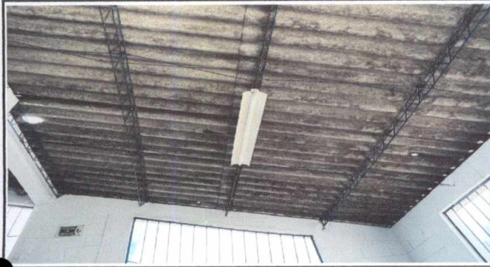
Foto 1: Techo de duralita de gradas hacia segundo nivel
