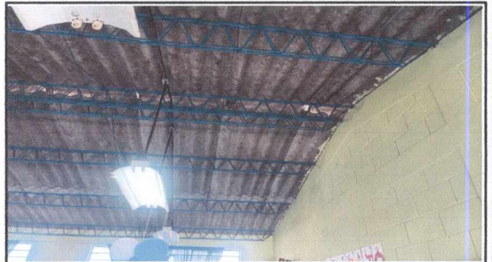
Foto 4: Techo de duralita de aula del segundo nivel (4o. A)
