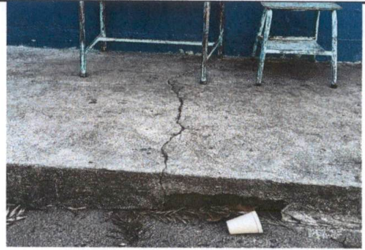
Foto 8: otra muestra el mantenimiento que se necesita en el piso de preprimaria.
