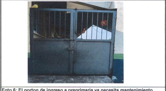
Foto 6: El portón de ingreso a preprimaria ya necesita mantenimiento, muestra oxidación.
