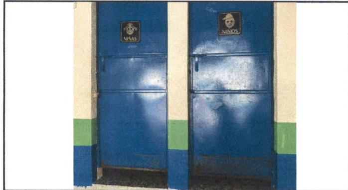
Foto 1: Las puertas necesitan mantenimiento, ya están empezando a oxidarse en la parte inferior. En una hace falta un pin, lo que provoca que se caiga.
