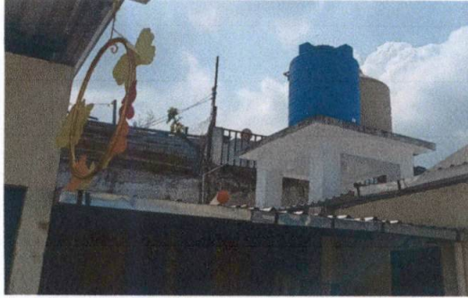
Foto 7: Los tincaos necesitan mantenimiento, actualmente por algun motivo no se llenan, lo que provoca falta de agua en el área de preprimaria.
