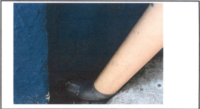
Foto 4: La salida del agua pluvial es muy pequeña, por lo que se inunda el patio, llegando a entrar a las aulas el agua.
