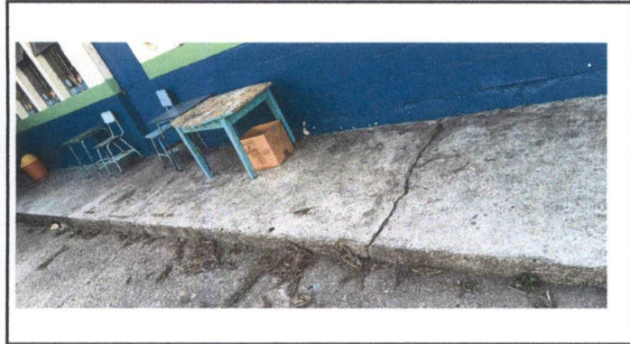
Foto 3: El piso de los corredores necesita mantenimiento, se está empezando a rajar.
