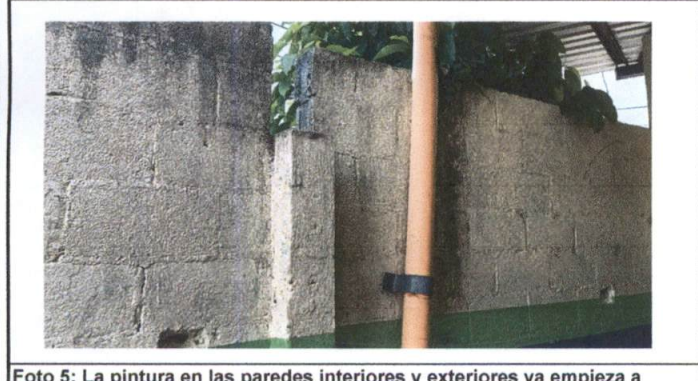
Foto 5: La pintura en las paredes interiores y exteriores ya empieza a mostrar deterioro por el paso del tiempo.
