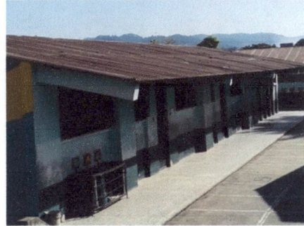
Foto 2: 1. CUBIERTA DE LAMINA 9. PINTURA EN MUROS
