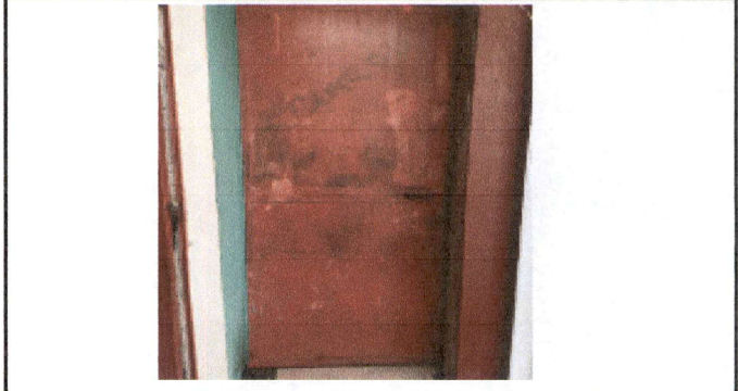
mantenimiento a puertas dañadas
