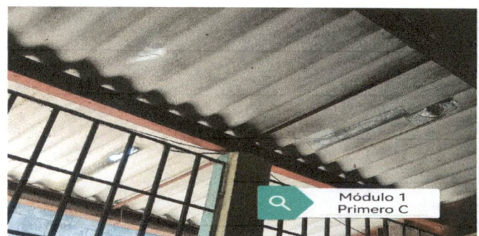
Foto 4: daño en cubierta de Duralita en el salón que ocupa Primero Básico, Sección "C"
