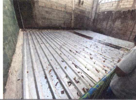
Foto 2: Sustrucción de lámina en bodega
