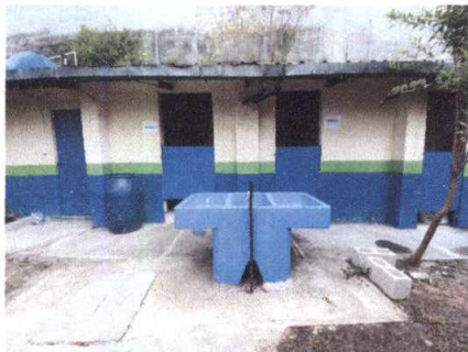
Foto 17: Instalación de pila en área de sanitarios de alumnos y alumnas, dirección y sanitarios de docentes.
