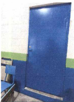
Foto 5: Sustrucción de chapa en puertas de área administrativa y laboratorio de computación
