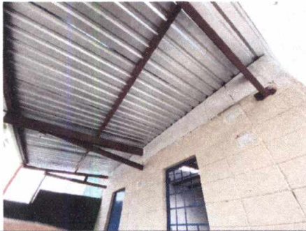
Foto 3: Sustrucción de lámina y levantamiento de dos hiladas por exceso de calor.
