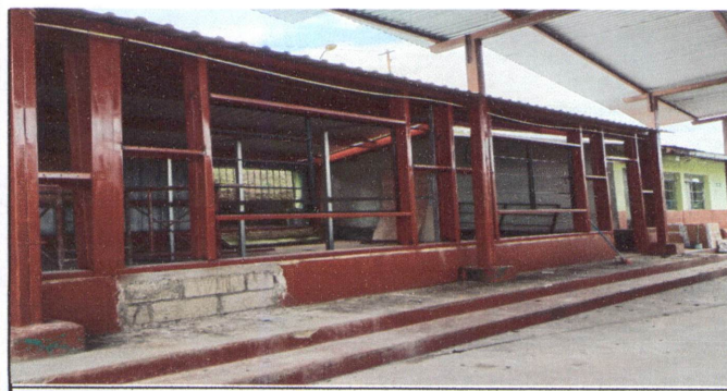
Foto 5: Aulas a desmontar por deterioro, para sustituir con materiales nuevos
