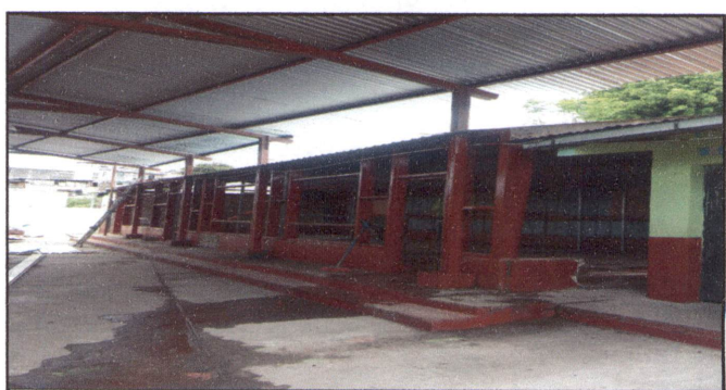
Foto 6: Aulas a desmontar por deterioro, para sustituir con materiales nuevos
