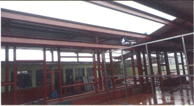
Foto 7: Sustitución de estructura de soporte de madera por metal, desmontaje de madera por metal e instalación de costaneras.
