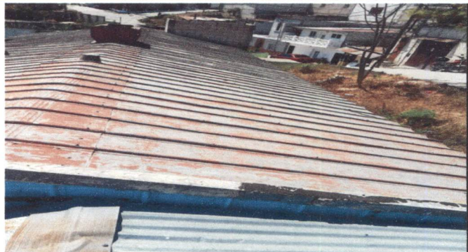
Foto 2: Sustitución de lámina, por lamina troquelada aluzinc calibre 26 (3 salones), desmontaje de lámina antigua e instalación de lámina nueva.
