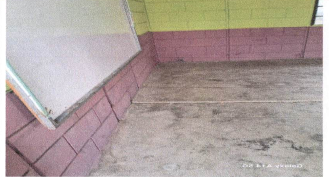
Foto 2: HUNDIMIENTO DEL PISO
