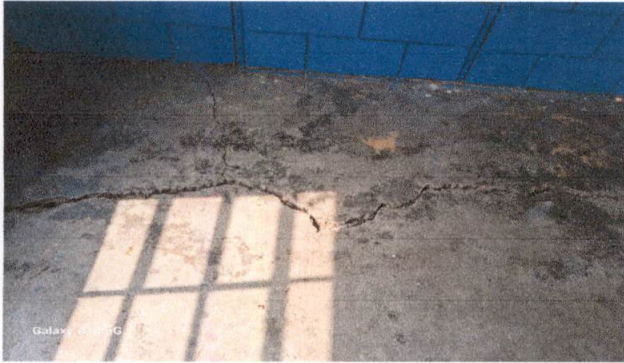
Foto1: EL PISO SE ENCONTRABA TOTALMENTE QUEBRADO
