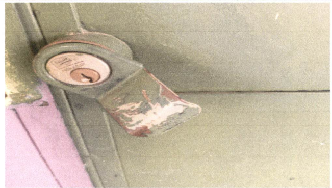
Foto 4: CHAPAS EN MAL ESTADO
