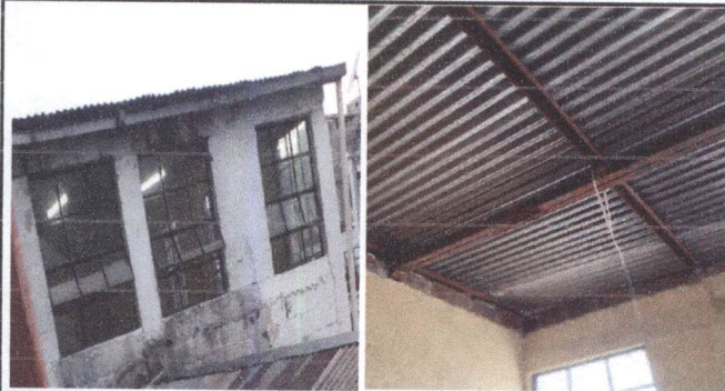
Foto1: AULA PLANTA ALTA: Desmontaje, fabricación de estructura y enlaminado en aula de planta alta, incluye instalación de canal.
