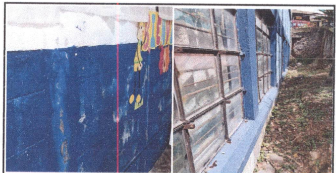
Foto 6: MURO EXTERIOR: Zanjeado en muro exterior, Aplicación de mortero para impermeabilización y aplicación de pintura a ambos lados del muro.
