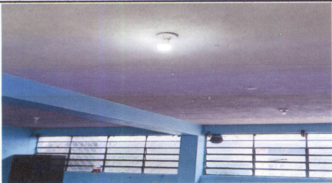
Sustitución de focos por lámpara led
