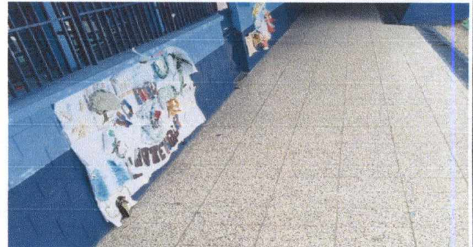
Foto7: Fabricacion de bancas de cemento de 1mts x 0.45 de profundidad en el area de corredores
