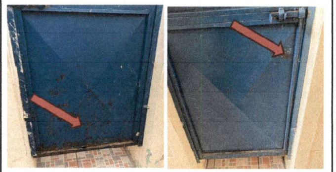
Foto 19 y 20: 10. SERVICIOS SANITARIOS Y SUS ACCESORIOS 10.1 Mantenimiento a estructura (lijado, sujeciones, aplicación de pintura) a 4 puertas de sanitarios niñas
