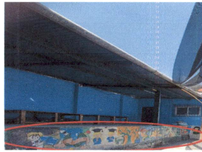
Foto 10: Reparación de pared del escenario y colocación de piso de cerámico de 43 centímetros esmaltado
