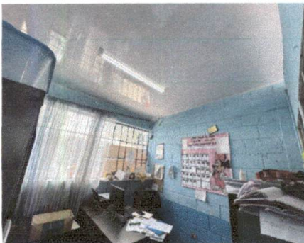
Foto 5: Mejoramiento de estructura de techo en laboratorio y área de dirección con cielo falso.
