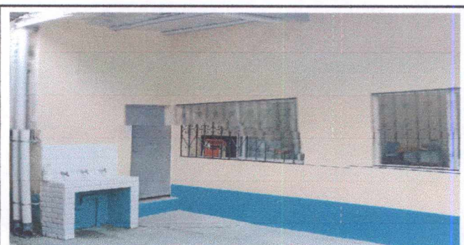
Foto 12: REPARACIÓN DE REPELLO Y CERNIDO DE PARDES: Incluye mantenimiento de paredes por mal estado, limpieza y picado de pared.
