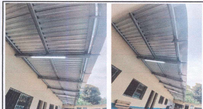
Foto 9: MANO DE OBRA ESPECIALIZADA (ELECTRICIDAD) : Instalación de unidades de iluminación en aulas de Párvulos, 1ro B y corredor.
