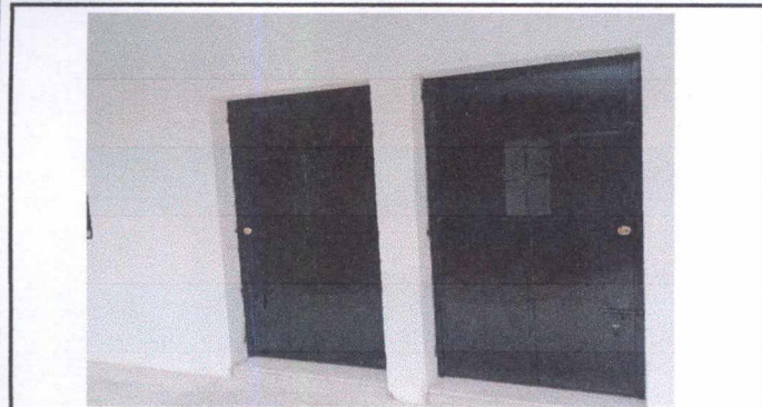
Foto7: MANO DE OBRA ESPECIALIZADA (HERRERIA) : Fabricación e instalación de puertas de metal en aulas de Párvulos y primero B. incluye pintura.
