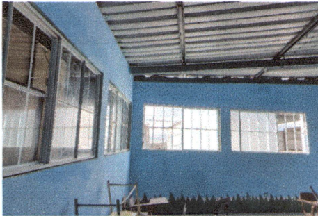
FOTO 3: INSTALACIÓN DE VENTANAS, APLICACIÓN DE REPELLO, CERNIDO Y PINTURA EN AULA DE PÁRVULOS
