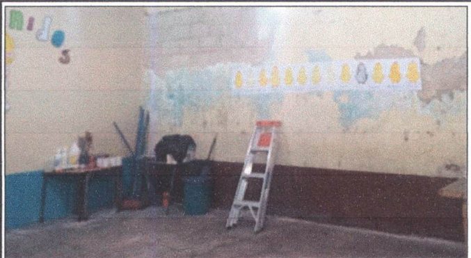
Foto 3: PISOS: Sustitución de piso de torta de concreto por piso granito. Incluye levantado de torta de cemento existente, aplicación de mezlón y nivelación de suelo. En aulas de párvulos, primero B y 5to.
