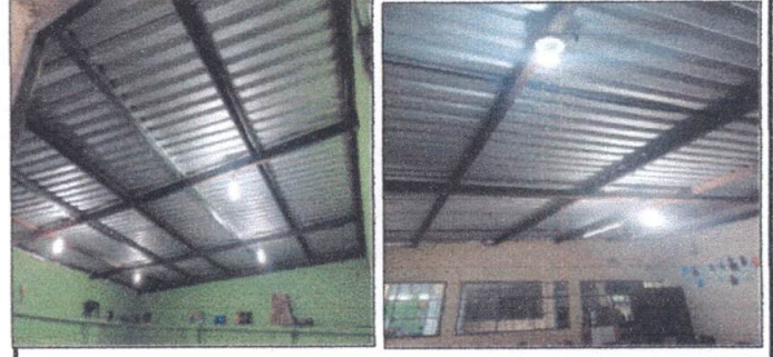
Foto 8: MANO DE OBRA ESPECIALIZADA (ELECTRICIDAD) : Instalación de unidades de iluminación con lámparas a prueba de polvo y humedad, con 2 tubos led de 18 watts (incluye interruptor, ducto y cable eléctrico) en aulas de Primero A, 6to.
