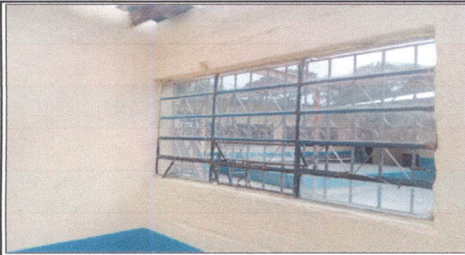
Foto1: VENTANAS : Sustitución de estructura de metal de ventanas en Parvulos y primero B. Se instalarán ventanas de aluminio anodizado tipo corredizas, vidrio claro de 6mm. de párvulos y primero B
