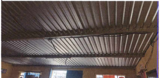
Foto 4: Sustitución de red electrónica, lámparas led
