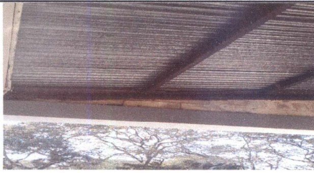
Foto7: Mantenimiento de estructura de metal donde se colocará nueva lámina de aluzinc troquelada calibre 26, lijada con fondo gris y aplicación de pintura roja en aula de 4to. Primaria Sección B
