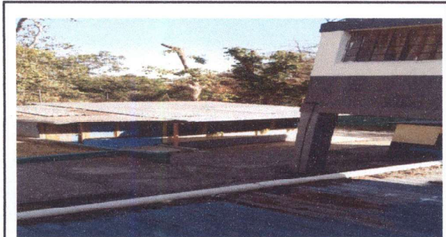
Foto 3: Sustitución de lámina de zinc acanalada que se encuentra con mucho óxido por lámina de aluzinc troquelada calibre 26 en grado de 3ro. Primaria Sección A
