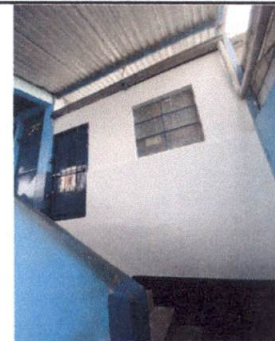
Foto 18: REPARACION DE REPELLO Y CERNIDO DE PAREDES (CUANDO APLIQUE). Aplicación de Base Gris Monocapa y acabado Blanco Monocapa en muro.
