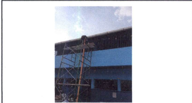
Foto 7 CANALES Y BAJADAS DE AGUA PLUVIAL. Bajada de agua pluvial tubería de 4" PVC
