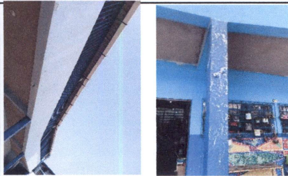
Foto 7: 7 CANALES Y BAJADAS DE AGUA PLUVIAL. Bajada de agua pluvial tubería de 4" PVC
