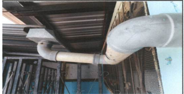
Foto 4.: Cambio de canal
