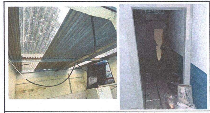
Foto 6: Cocina sin pendiente y sin ampliación del techo
