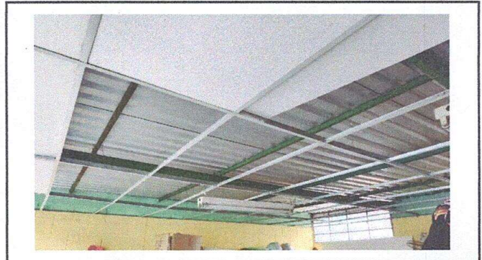
Foto 2: Cielo falso de aula (1ero B)
