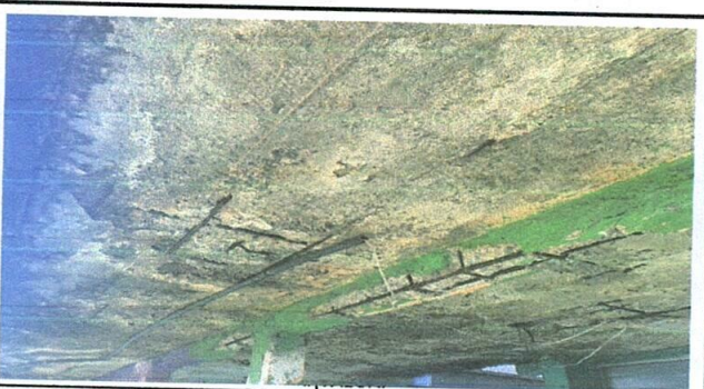
Foto: LOSA DAÑADA CORREDOR - PASILLO
