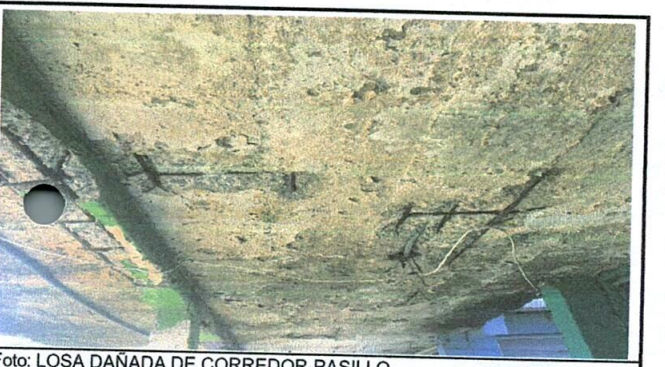
Foto: LOSA DAÑADA DE CORREDOR-PASILLO
