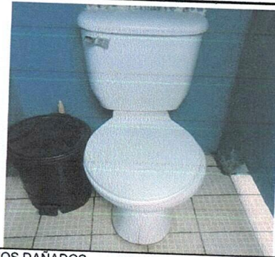
Foto: SANITARIOS DAÑADOS
