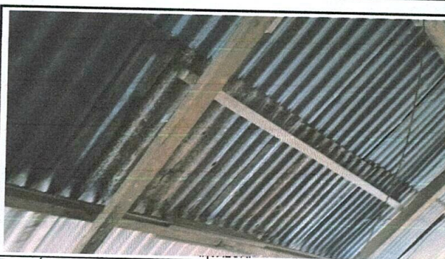
Foto: LÁMINAS Y MADERA DAÑADAS MÓDULO BODEGA-GUARDIANIA
