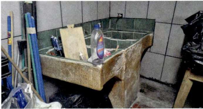
Foto 1: Sustitución de pila de dos lavadero por pila de concreto, cubierta con azulejo
