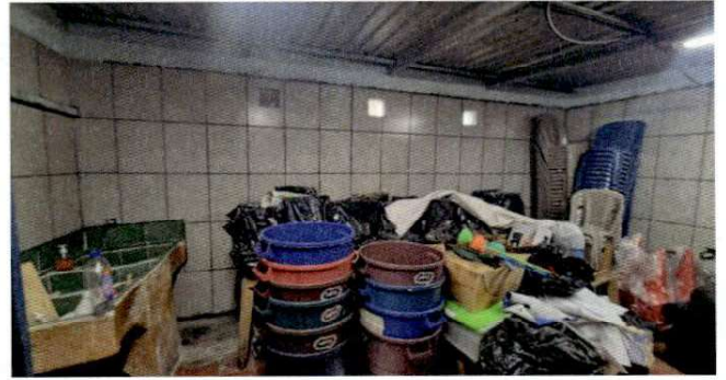
Foto 2: Área donde se trabajaran gabinetes fundidos, con puertas de metal, demolición de muro para instalación de ventana tipo PVC e instalación de puerta metálica.
