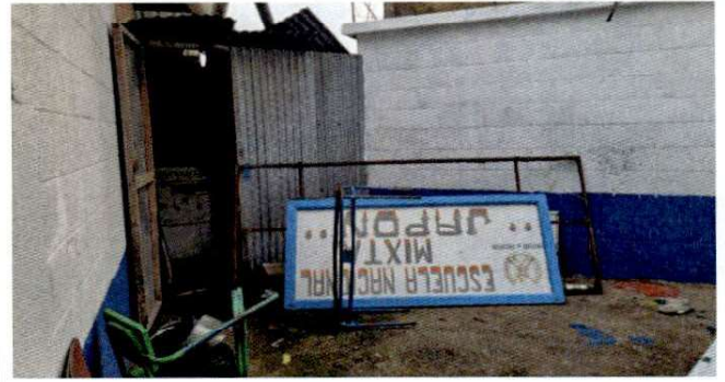
Foto 4: Área donde se realizara levantado de muro para cerrar área de bodega de cocina.
