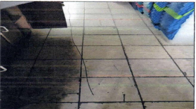
Foto 6: El piso esta muy deteriorado.
