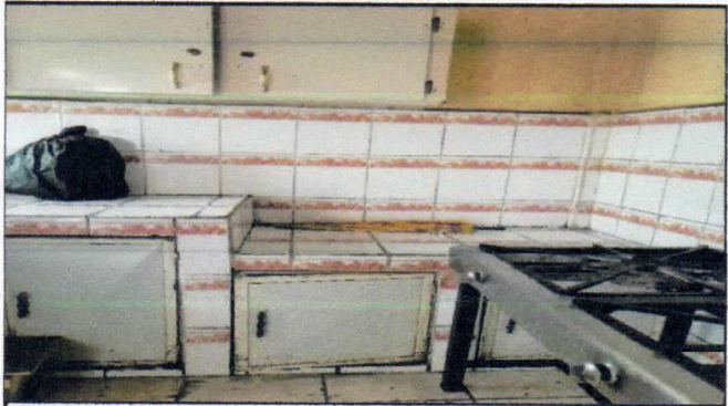
Foto 2: El área de cocina es provisional.
