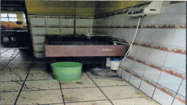
Foto 5: La pila provisional ya esta muy deteriorada.
