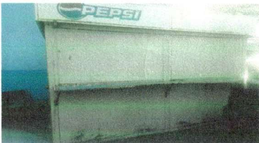
Foto 5: Tienda Escolar en mal estado
