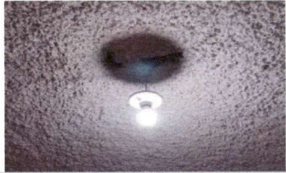
Foto 10: Esta imagen muestra el sistema electrico deteriorado el cual sera reparado.
