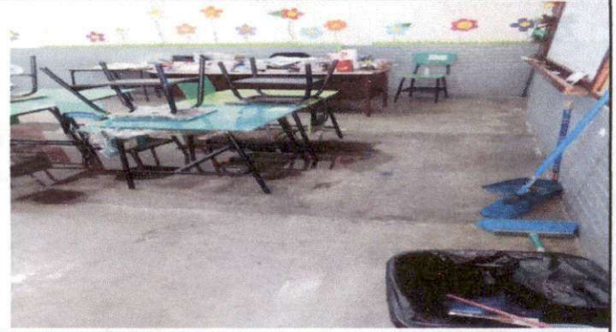
Foto 2: Esta imagen muestra el piso de torta y pintura deteriorada del aula 2, el cual será sustituido por piso ceramico y pintura.
