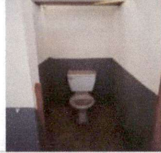
Foto 8: Esta imagen muestra 1 de los 2 sanitarios deteriorados que se encuentran en el segundo nivel, los cuales serán sustituidos y habilitados.
