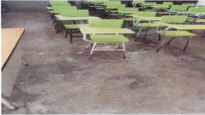
Foto 1: Esta imagen muestra el piso de torta deteriorado del aula 1, es cual será sustituido por piso ceramico.
