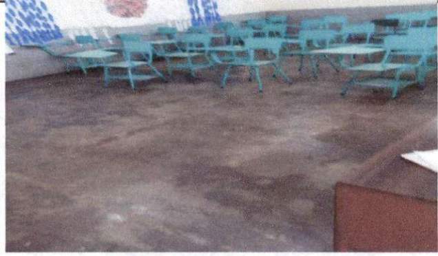
Foto 4: En esta imagen se muestra el piso de torta y pintura deterioradas del aula 4 el cual será sustituido por piso ceramico y pintado nuevamente.
