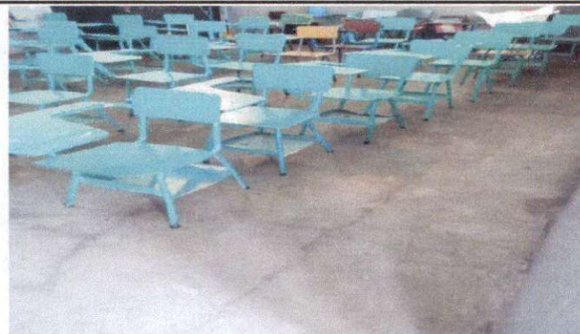
Foto 3: En esta imagen se muestra el piso de torta deteriorado del aula 3 el cual será sustituido por piso ceramico.
