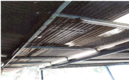
Foto 3: ESTA IMAGEN MUESTRA LO DE LA PARTE DEL CORREDOR DE PREPARATORIA QUE SE HARA LA SUSTITUCION DE LAMINA
