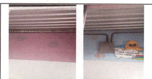
Foto 6: Vista interior de servicios sanitarios sin iluminación
