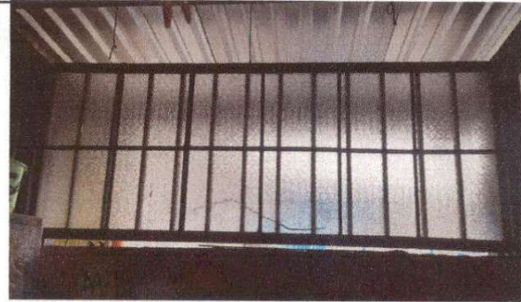
Foto 10: Interior de salón con ventana existente que no puede abrirse para ventilar
