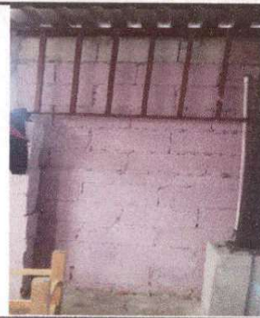
Foto 8: Pared incompleta del interior del salon de clases
