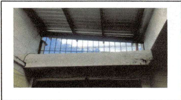
Foto 4: Bajada de agua de la pestaña
