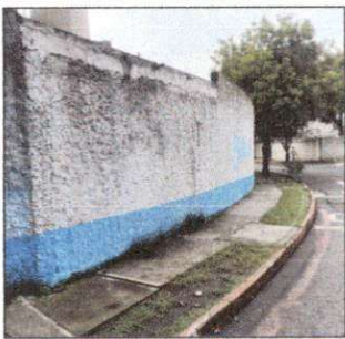
Foto 5: Pintura del perimetro de la escuela en mal estado.
