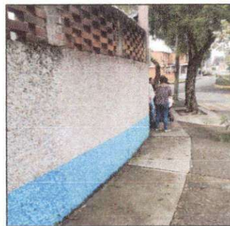
Foto 6: Pintura del perimetro de la escuela en mal estado.
