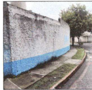
Foto 4: Perimetro de la escuela en mal estado (Pintura)
