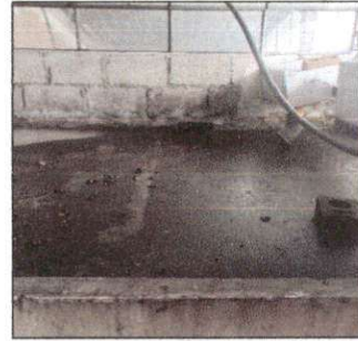
Foto 2: Estado de la tubería de la terraza
