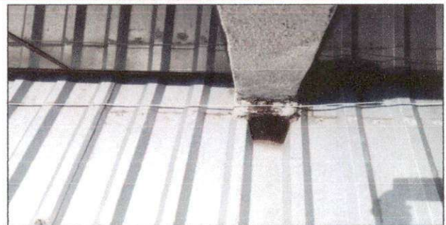
Foto 6: Estructura de metal en mal estado
