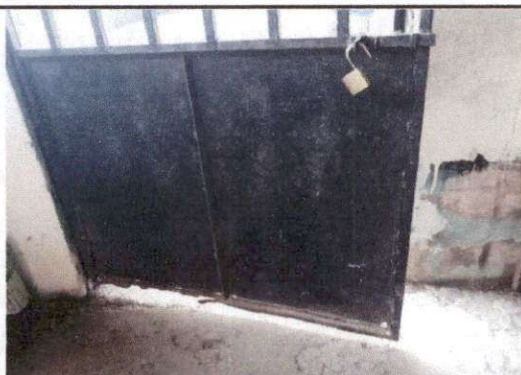
Foto 3: Esta imagen muestra el Porton deteriorado el cual sera reparado y pintado.
