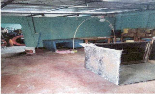
Foto 1: Esta imagen muestra el piso deteriorado del área de cocina el cual será sustituido por piso cerámico.
