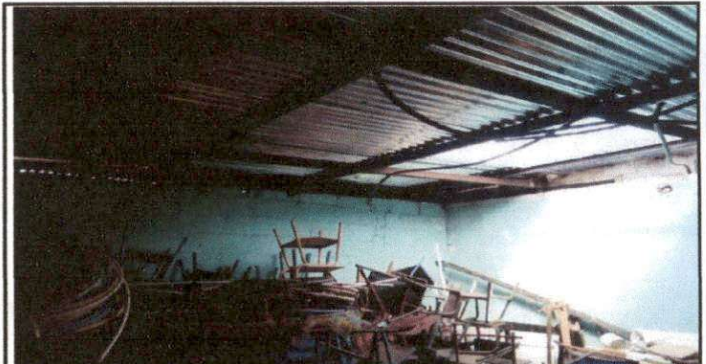
Foto 4: Esta imagen muestra las paredes deterioradas del área de cocina, las cuales serán repelladas y pintadas.
