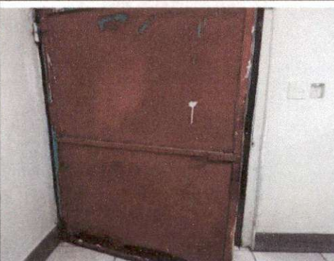
Foto 4: Esta imagen muestra las puertas deterioras las cuales serán reparadas y pintadas.
